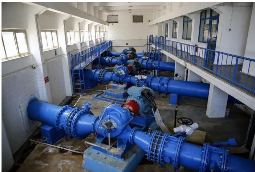
Bombas en estación de bombeo de agua potable
