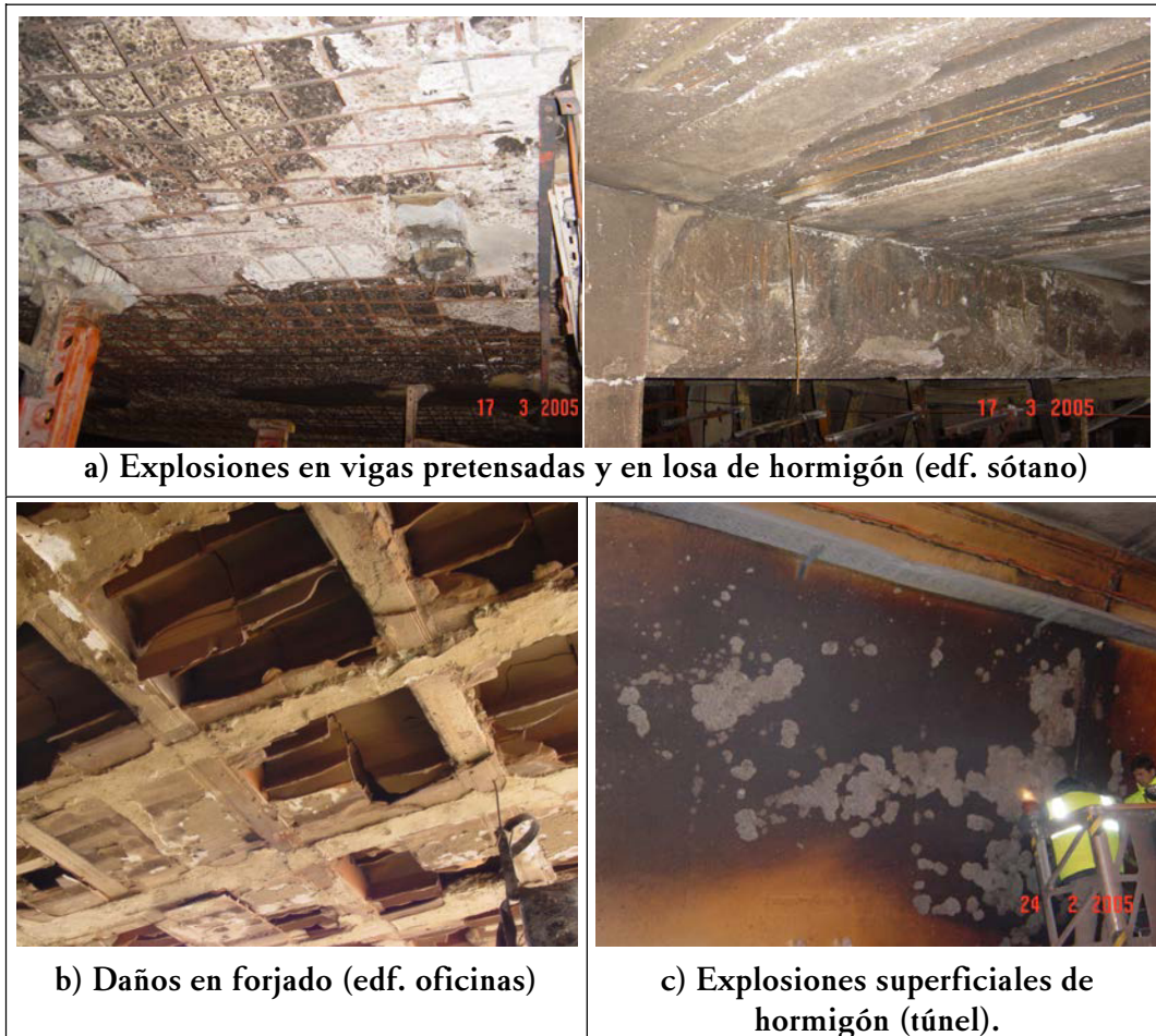
Figura 1. Daños en elementos de hormigón después del incendio.
