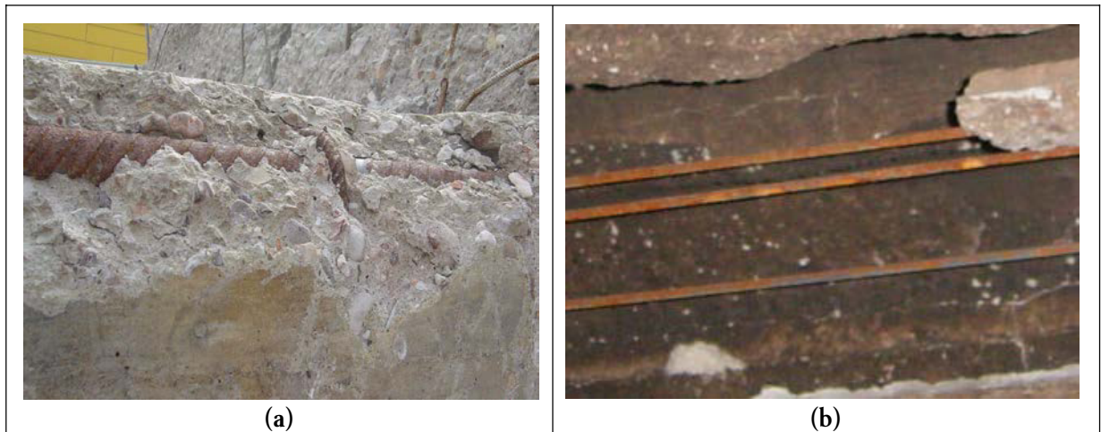
Figura 2. a) Armadura expuesta en esquina en viga. b) Explosión en vigueta pretensada y acero expuesto tras saltado del recubrimiento.
