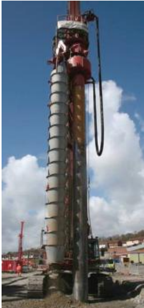
Fig 3.2, Perforadora de hélice continua, con instalación de ademe metálico y mecanismo para descarga de suelo producto de perforación
