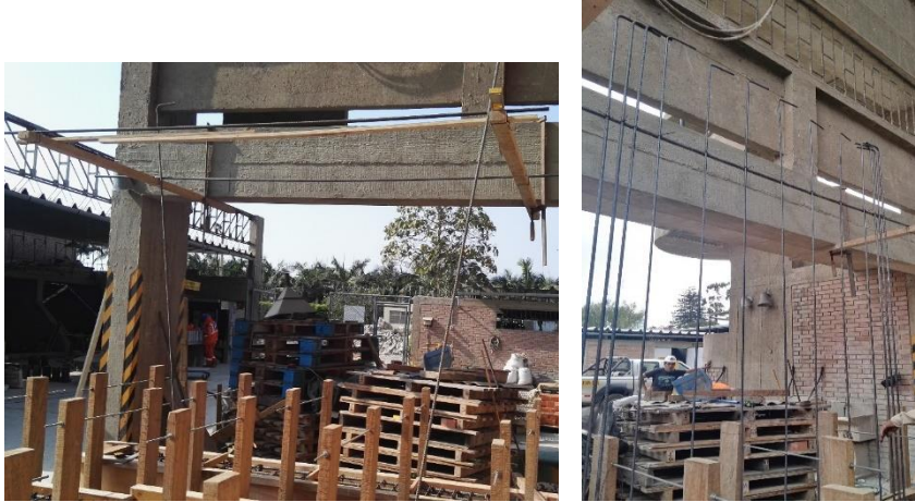
Figura 3.9. Estructura acondicionada para soporte del enmallado de acero de refuerzo de los muros.
