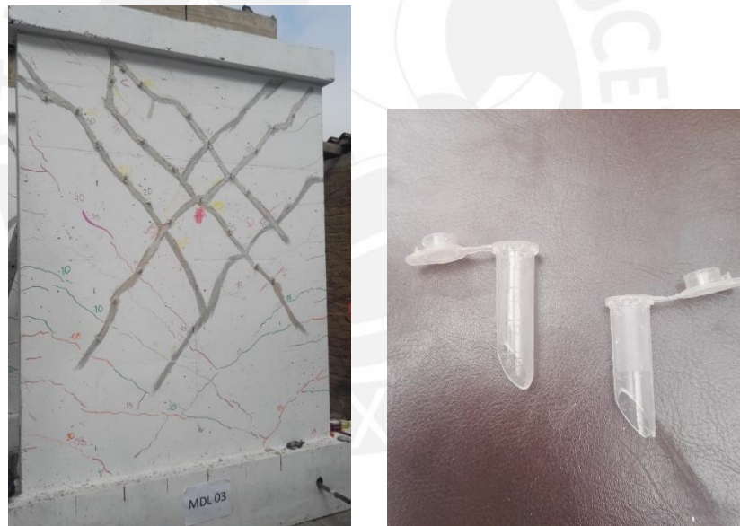
Figura 5.5. Izq. Muro listo para la inyección del epóxico. Der. Boquillas usadas cada cierta distancia en cada canal de fisura.
