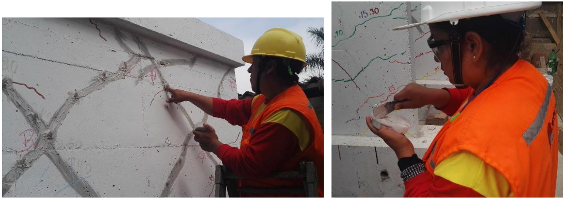
Figura 5.4. Aplicación de la combinación de mezcla "A" y "B" en la dirección de las grietas identificadas.
