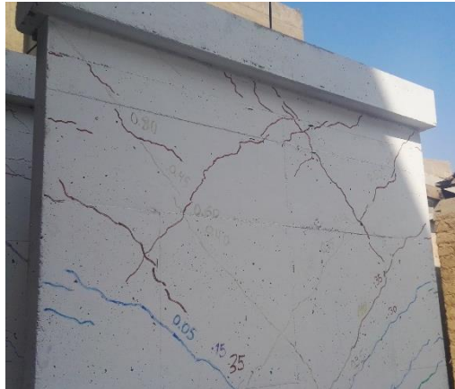
Figura 5.2. Muro 02 con grietas mayores a 0.50 mm identificados.
