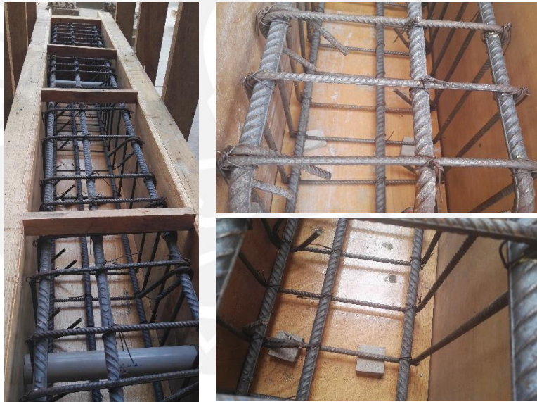
Figura 3.8. Izq. Pases para tubos de PVC en el armado de la viga de cimentación. Der. Uso de tacos en la base de la viga de cimentación para cumplir con los recubrimientos de acuerdo a planos.
