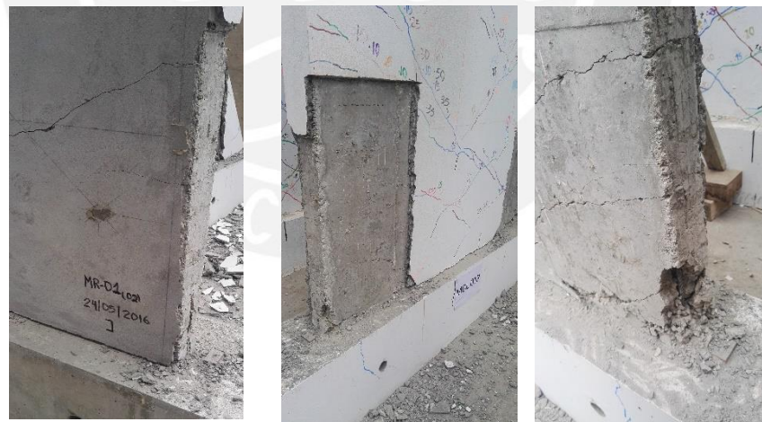
Figura 6.48. Fallas encontradas en el MDL 01 luego de la auscultación.
