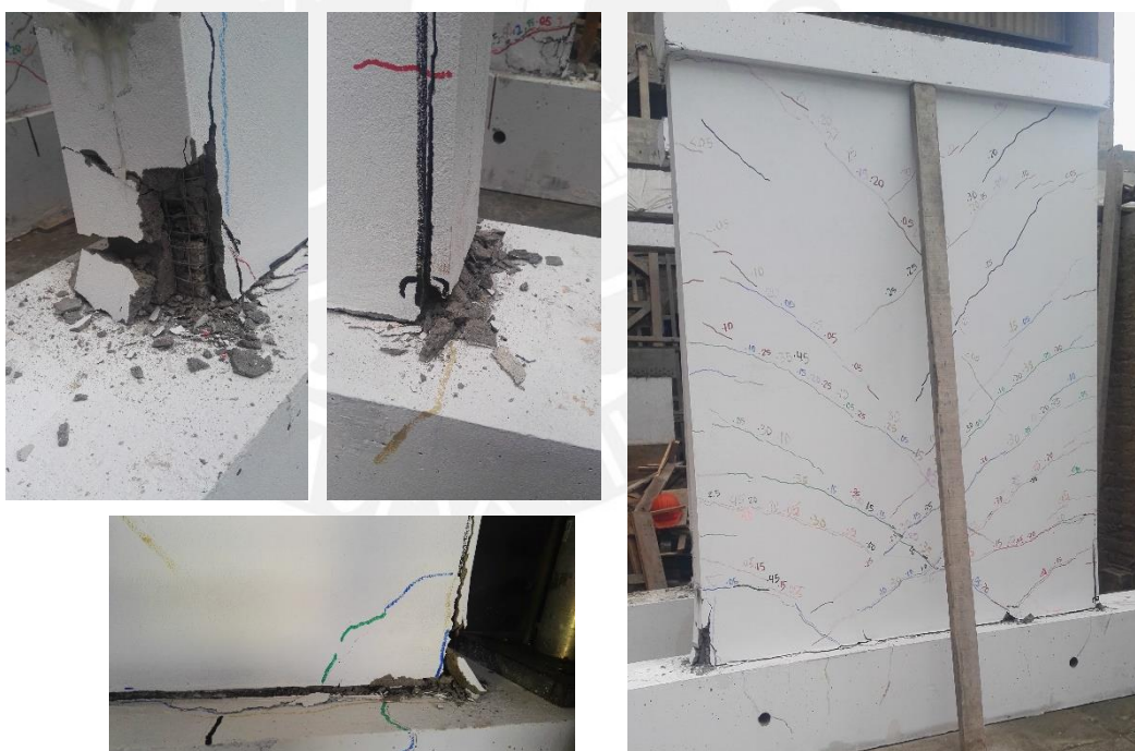
Figura 6.46. Estado final post-ensayo MDL01-R-SCA
