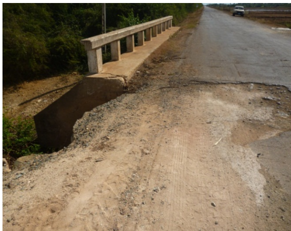
Figura 2.3 Daños en talud de aleros en puente.
