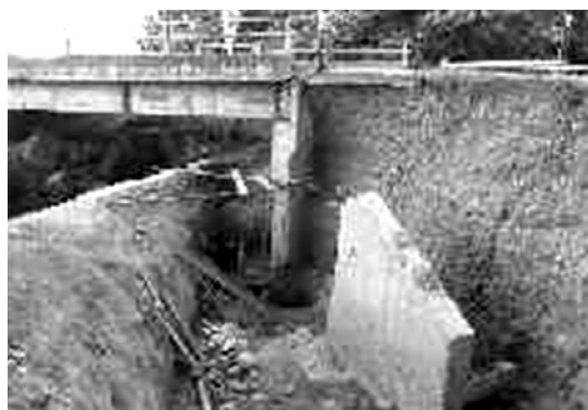
Figura 1.15. Erosión y Socavación. Puente El Cerrito.
