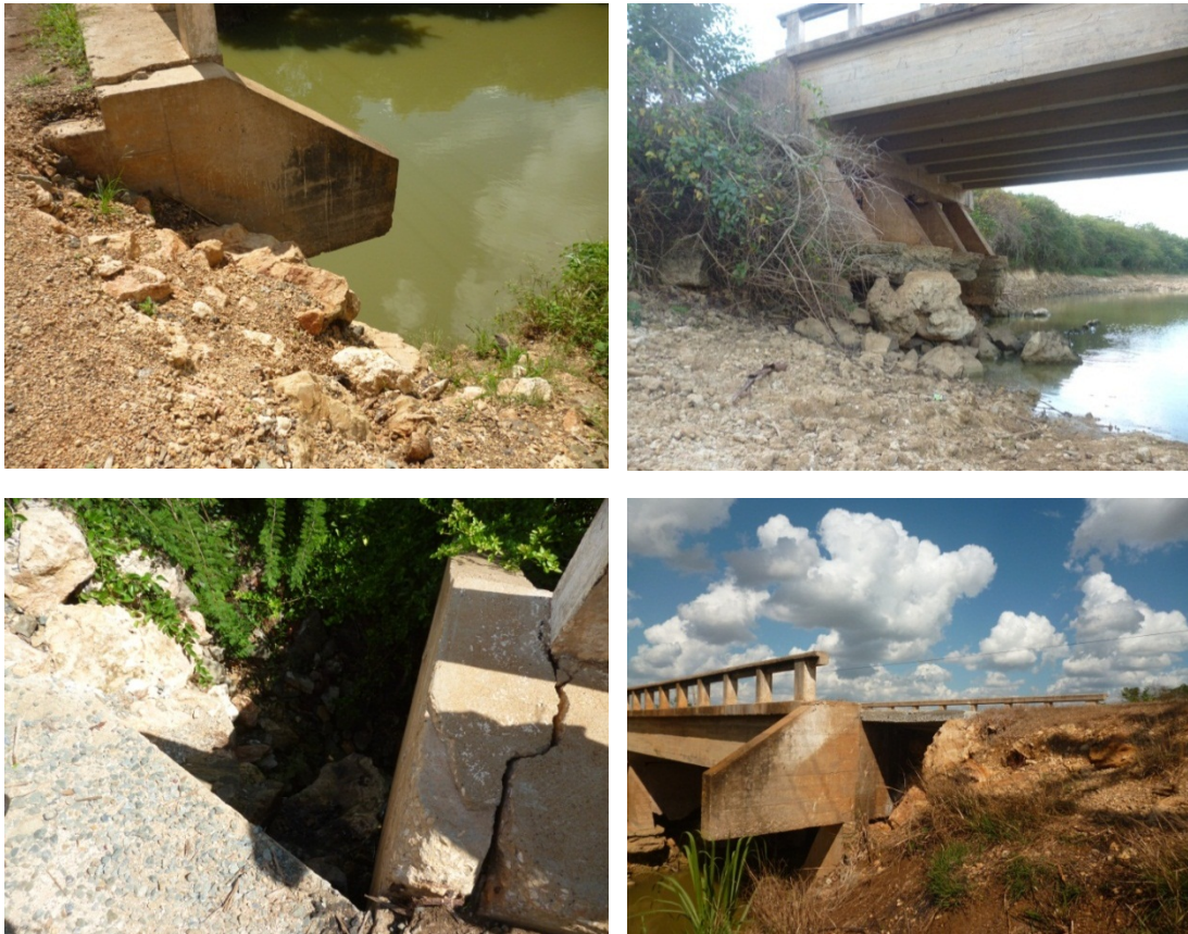
Figuras 2.10 -2.13 Daños de los conos, taludes y aletas.
