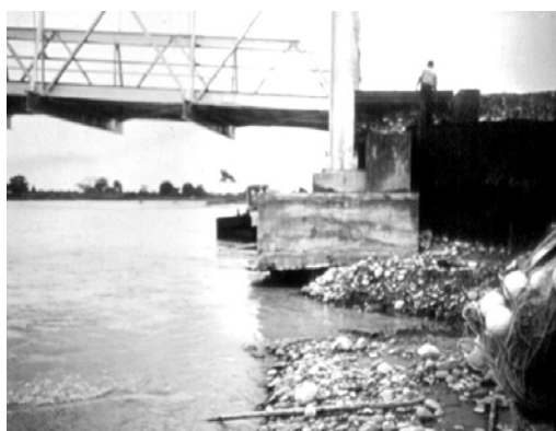
Figura 1.21. Socavación local en estribos.
