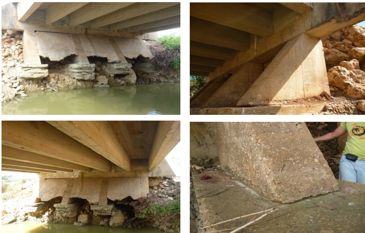
Figuras 2.19 -2.22 Daños en estribos.
