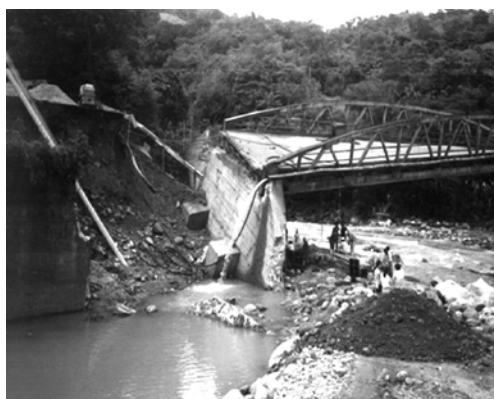
Figura 1.22. Colapso del estribo del Puente Únete.
