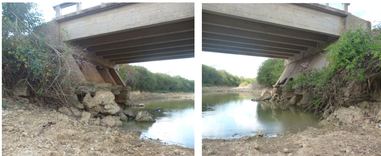
Figuras 2.23 y 2.24 Causas de los daños en estribos.
