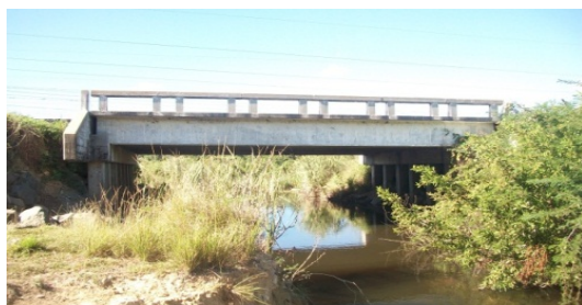
Figura 1.36. Arrastre del talud de apoyo.
