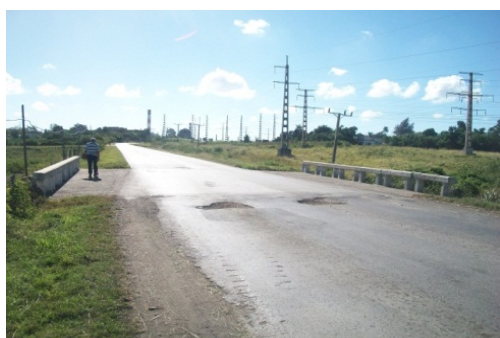
Figura 1.34. Presencia de huecos lado Fábrica de fertilizantes.
