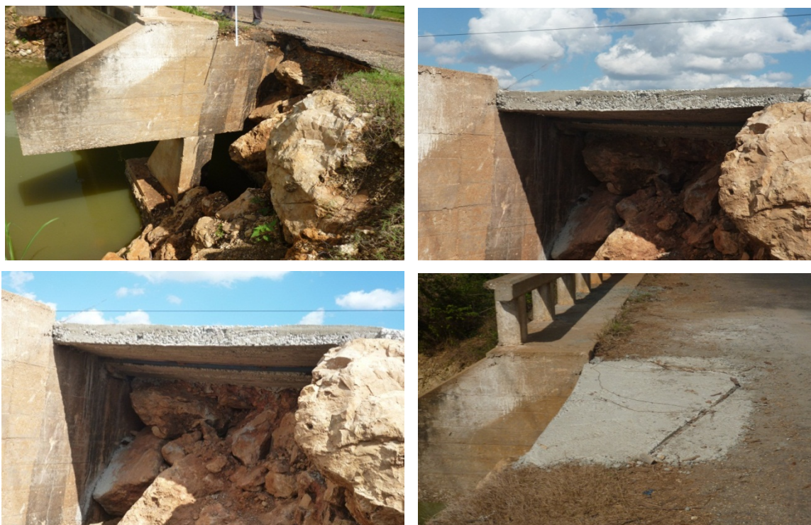
Figuras 2.6 – 2.9 Reparaciones anteriores de las losa de aproches.
