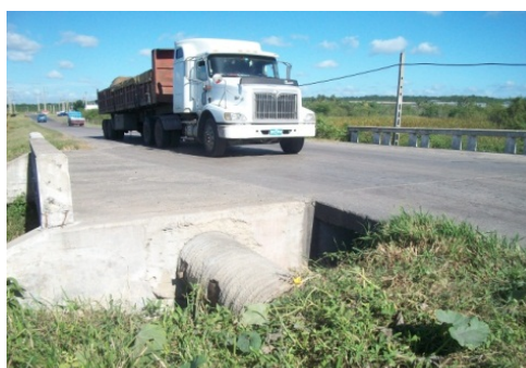
Figura 1.35. Socavación en losa de apoyo de lado Cienfuegos.
