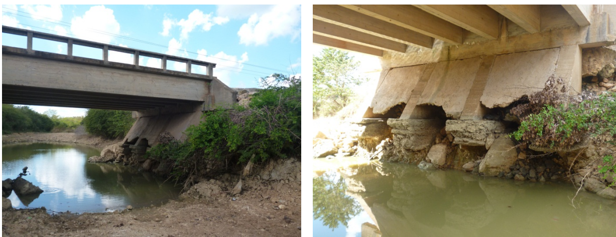
Figuras 2.14 y 2.15 Causa de los daños por la socavación del cauce.
