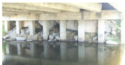
Figura 1.37. Socavación en estribos.
