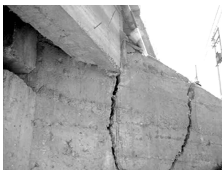
Figura 1.14. Grietas por falta de capacidad de carga de las aletas. Puente Venecia.
