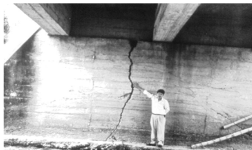
Figura 1.18. Problemas de capacidad de carga. Puente las Juntas.
