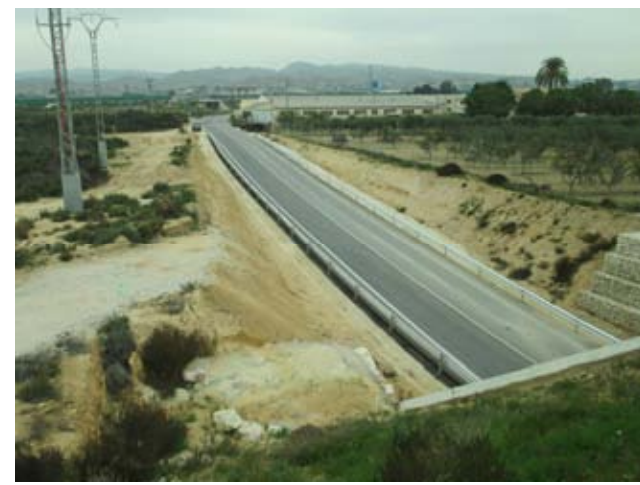
85 Desmontes en UG.1 limosa en paso inferior en estación de AVE
