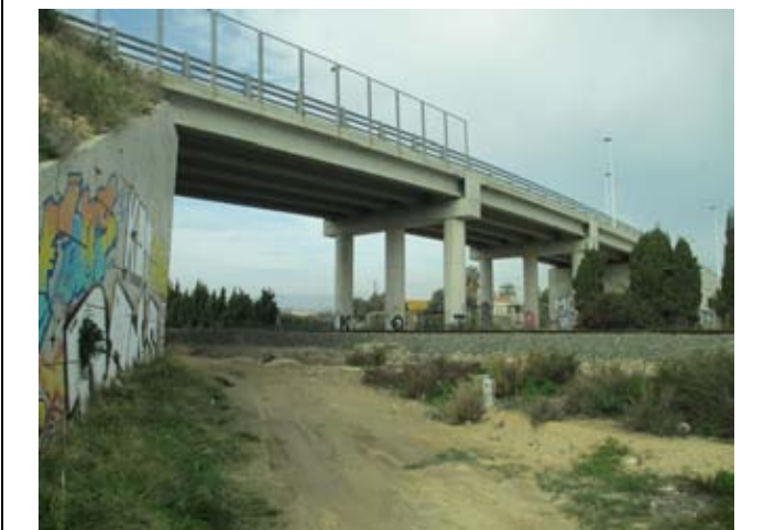
32 Parcelas deprimidas en proximidad de la vía, formando puntos bajos con drenaje deficiente (PK 6+800).
