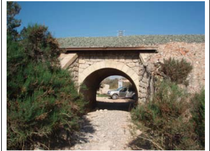
35 Obra de drenaje y de paso en la Plá de Sant Joseph (PK 7+400).
