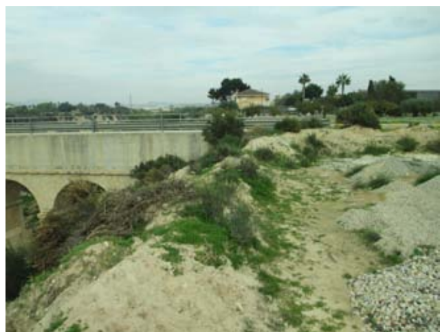
52 PK 8+700: escombros en proximidad estribo este canal
