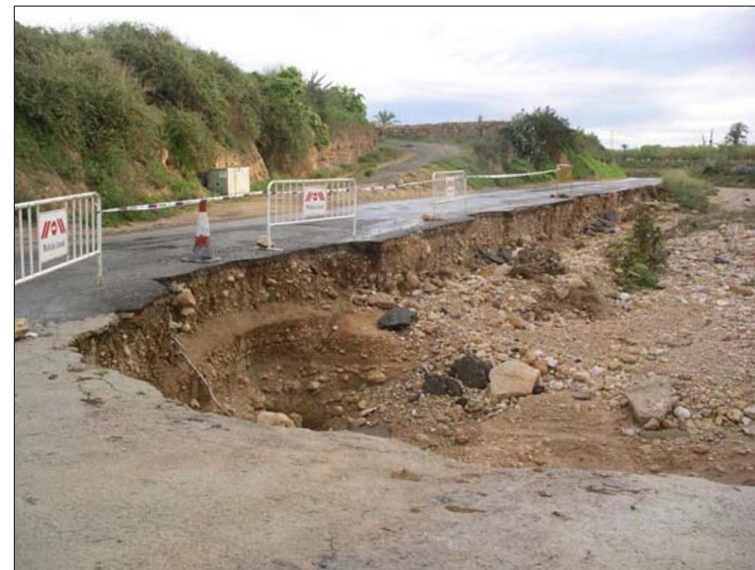
FIGURA 37. SOCAVACIÓN EN EL BC. BARBÓSENA.
