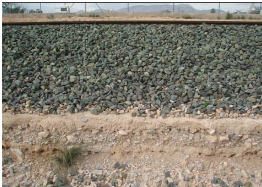
FIGURA 24. CAPA DE ASIENTO DE LA VÍA FÉRREA EXISTENTE.
