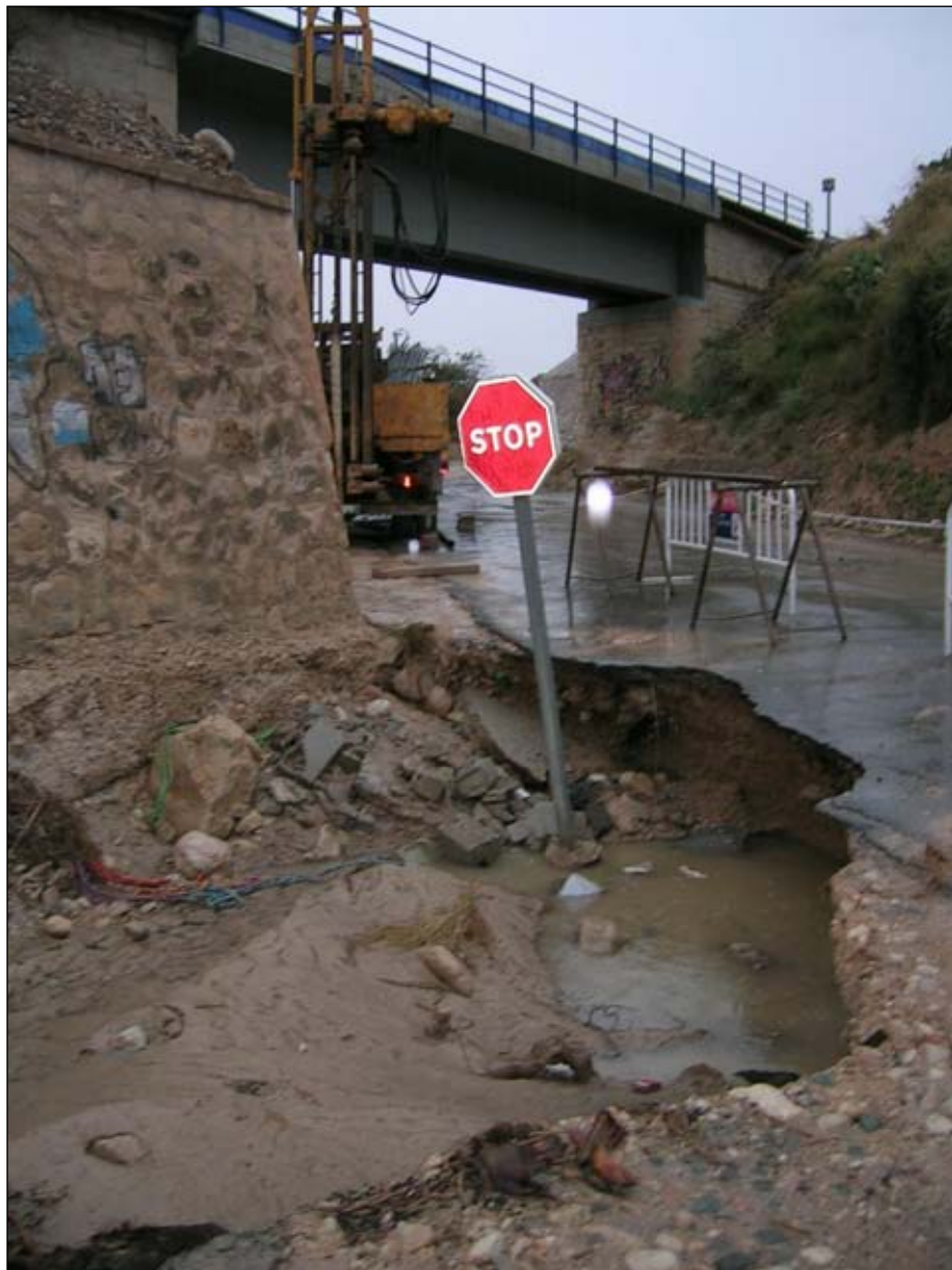
FIGURA 38. SOCAVACIÓN DEL CAMINO ASFALTADO QUE DISCURRE POR EL BCO. BARBÓSENA.
