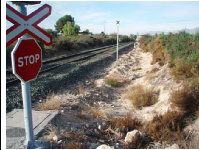
34 Desmorte de pequeña envergadura en suelos aluviales algo remoldeados en proximidad del PK 7+000.
