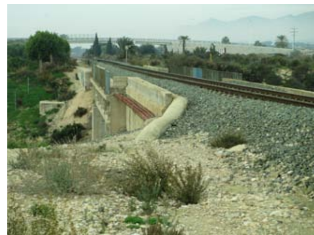
29 Plataforma del ferrocarril en la estructura que cruza el Barranco de Arcs (Monjas)
