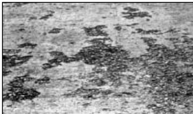
Descascaramiento de las superficies de concreto
